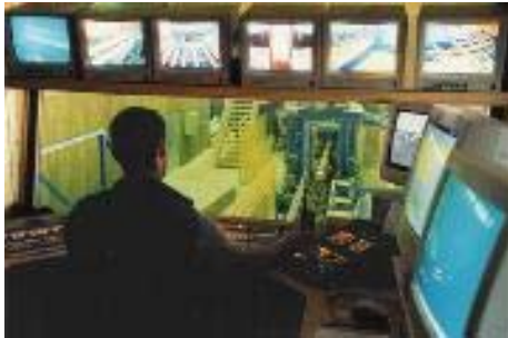
Steuerpult zur Bedienung der Blockbandsäge
